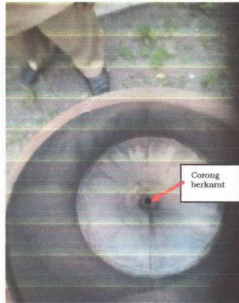
Gambar L2.3. Kondisi corong PCH Gemawang
