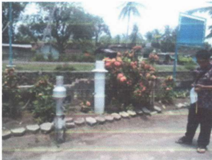
Gambar L1.4 - Kondisi PCH Brosot yang tidak memiliki pagar
